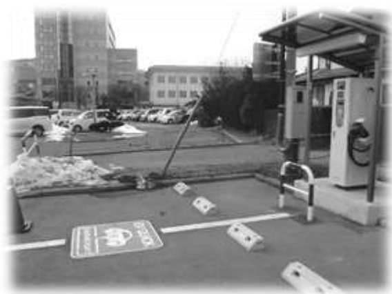
電気自動車の急速充電器
