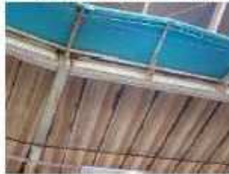
床デッキ：塗装劣化、錆
