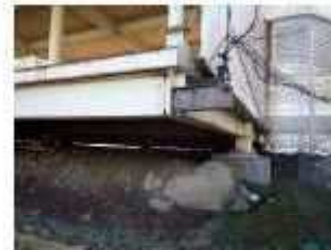
梁：塗装劣化、錆
