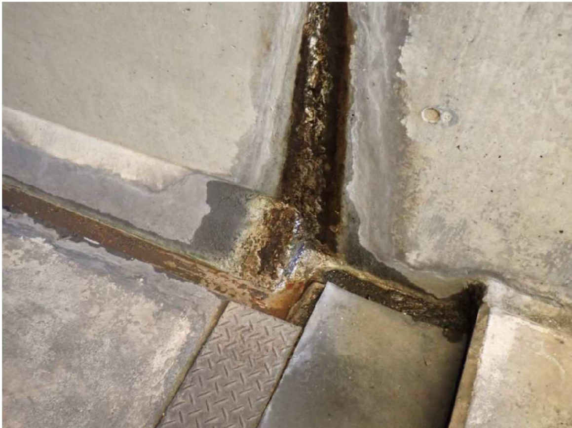
通路部の漏水
