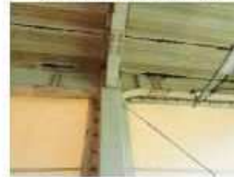
鉄骨部：塗装劣化、錆
