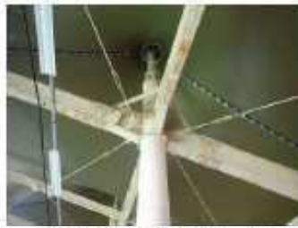
鉄骨部：塗装劣化、錆
