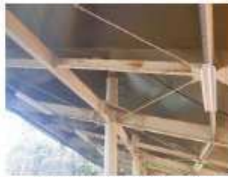
鉄骨部：塗装劣化、錆
