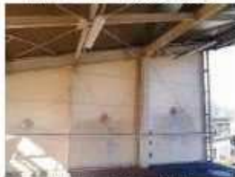
膜材：変色、劣化
