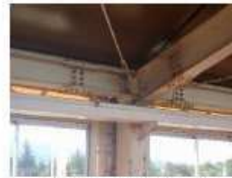
鉄骨部：塗装劣化、錆
