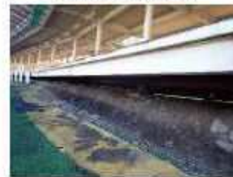
床先端：塗装劣化、錆
