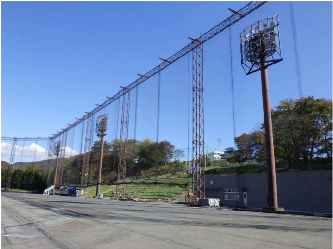
D 夜間照明設備（水銀灯） 6基 高さ 20.1m 架台 3.9m
