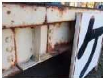
床先端：塗装劣化、錆
