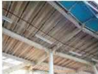
床デッキ：塗装劣化、錆
