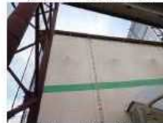
膜材：変色、劣化
