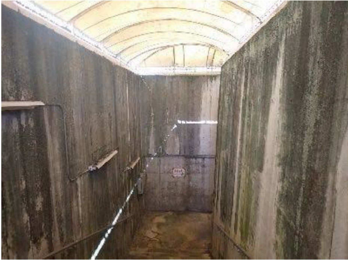
テントハウス側の壁面の状況（汚れ）
