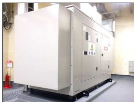
北大塩中区配水池 自家発電機
