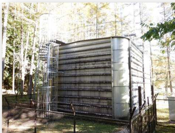
北大塩高区配水池
