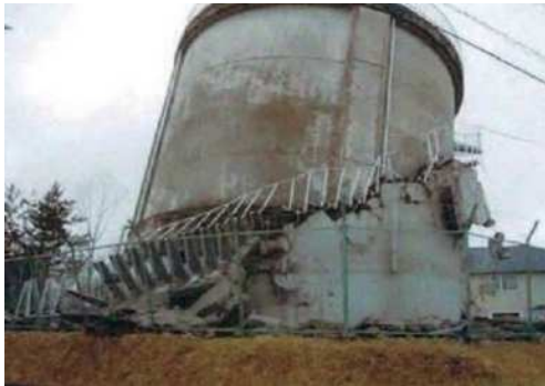
出典：東日本大震災水道施設被害 状況調査最終報告書 （厚生労働省・平成25年3月）
