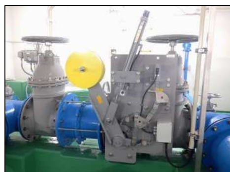
埴原田配水池 緊急遮断弁
