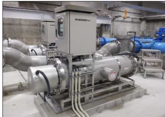
紫外線処理設備
