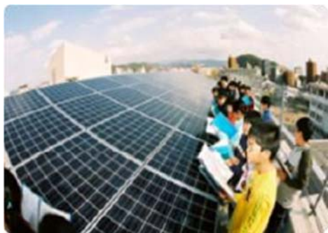
小学校の屋上に設置された太陽光発電太陽光発電システムを見学する児童。
