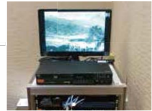
議場内 議会中継システム
