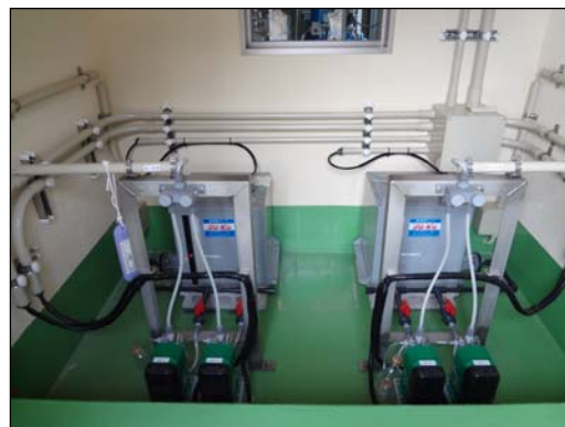
塩素消毒設備
