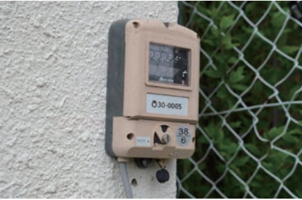
▲水道メーター(一部)
