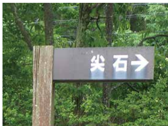
写真 4-16 誘導標識（支柱の割れ、板面の劣化）
